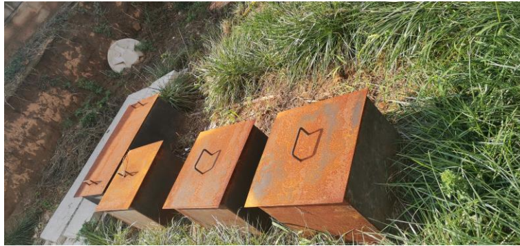
地埋式污水处理设施
