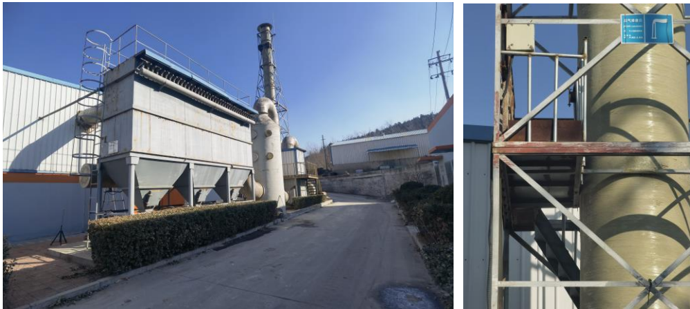
布袋除尘器+碱洗塔+光氧（DA001）
