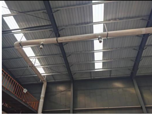
发酵车间废气收集管道
