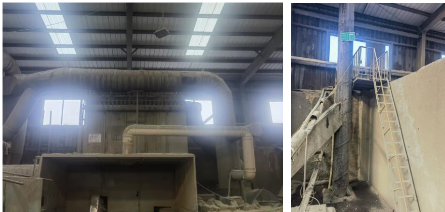
布袋除尘器及采样平台 (DA004)
