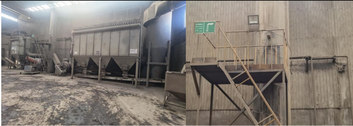
布袋除尘器及采样平台 (DA005)
